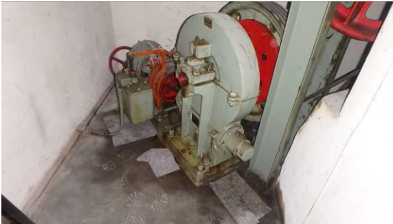
Öljyjäämiä hissikonehuoneessa (213 kellari)
