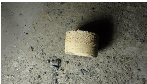
Lattioiden pintamassat (magnesiummassa) sisältävät asbestia
