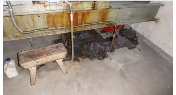
Öljyjäämiä hissikonehuoneessa (213-211, 4. kerros)
