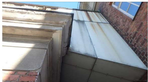
Käytävän ja hissien julkisivulevytyksessä on käytetty asbestia
