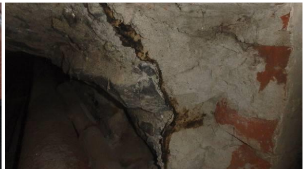
Rakennusten 212 ja 218 rajakohdan seinän bitumihuovassa on asbestia
