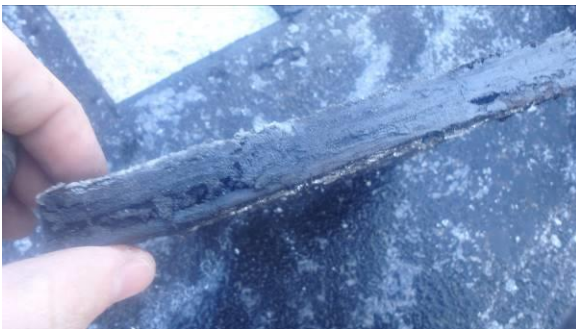
ASB.94: rakennuksien/osien vesikatteet, bitumikermi, sisältävät asbestia
