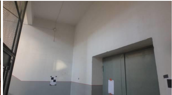
Porrashuoneen (213) seinämaaleissa on vaarallista jätettä
