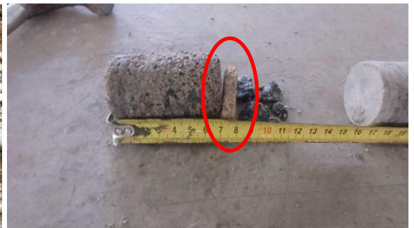
Parkkihallin (213, P2) vanha lattiapinnoite sisältää asbestia, vanhan lattiarakenteen päällä sorakerros ja betonilaatta
