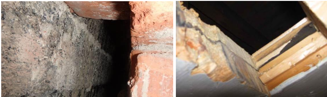
Perusmuurin sivelyssä on PAH-yhdisteitä yliRakennuksien 213 ja 214 yläpohjassa on vaarallisen jätteen raja-arvon käytetty terwapahvia (kuva Optiplan 2016)
