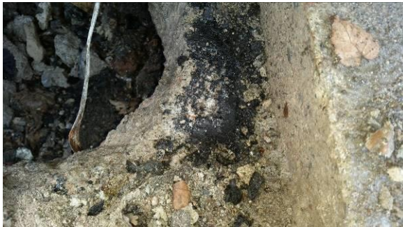
Pihakannen vanha vedeneriste, bitumikermit, sisältää asbestia
