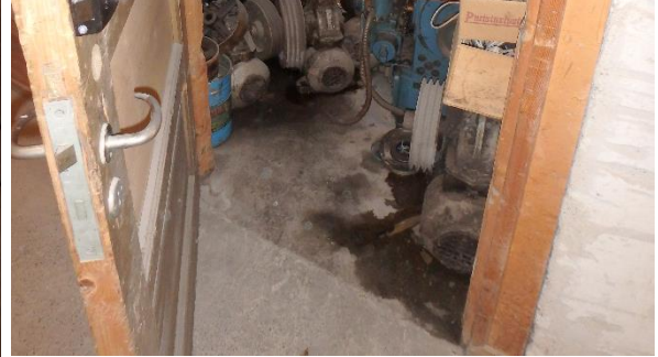
Öljyjäämiä tekstiilikaluston varastotilassa (213, kellari)
