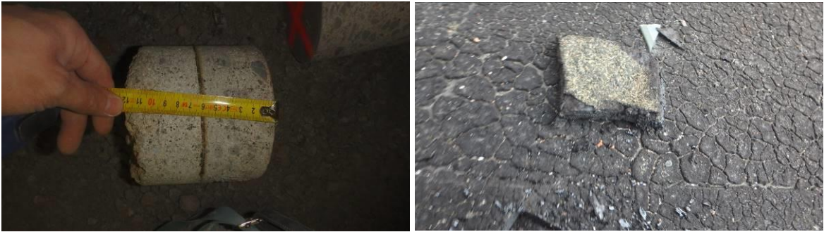
Bitumihuopaa on käytetty myös alapohjassa Vesikatteen kermeissä, ASB.77 ja ASB.78, kahden laatan välissä asbestia
