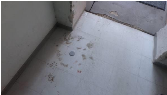
Vinyylilaatoissa (osassa) ja niiden liimoissa on käytetty asbestia
