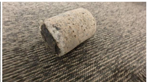
Kaksoislaatan välisessä kosteudeneristeessä on käytetty asbestia
