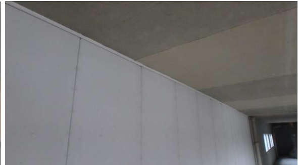
Alakatön (218) lujalevyssä on käytetty asbestia
