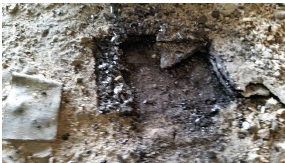
Kellarin (213) katoksen bitumikermissä on asbestia
