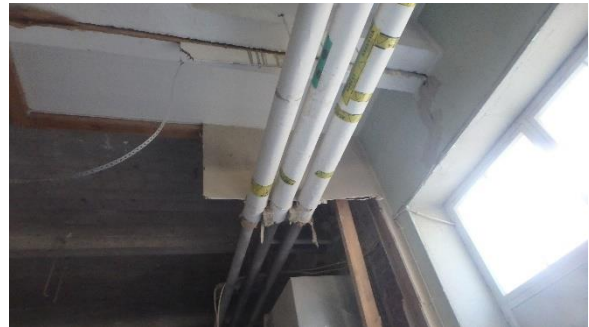
Vanhoissa putkien pahvieristeissä ja massoissa on käytetty asbestia
