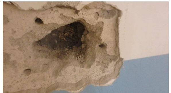
Rakennuksen perusmuurin sisämuurauksen muuri on erotettu sisäverhouksesta bitumi-takana oleva bitumihuopa (ASB.28 ja huopalla, kuva ensimmäisestä kerroksesta ASB.29) sisältää asbestia
