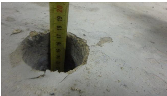
Lattiamaa (kattilahuone) sisältää vaarallista jätettä
