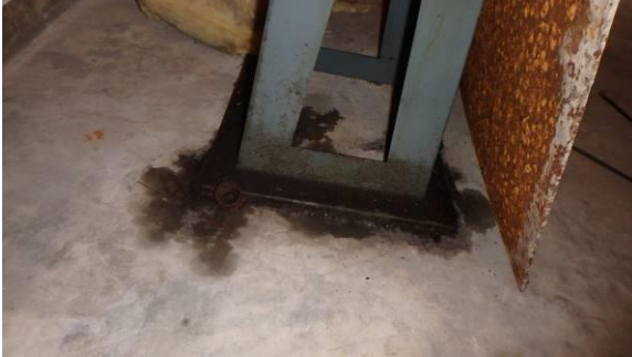
Öljyjäämiä vanhan puhaltimen alla (213, kellari)
