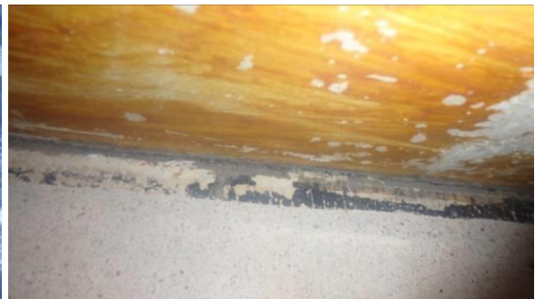
ASB.95: lattian mustaa pikilimaa on poista- matta 2. kerroksen lattian reunoilta
