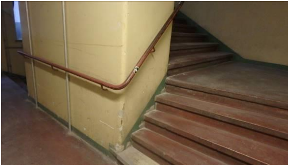
Porrashuoneen (211-213) seinämaaleissa on vaarallista jätettä
