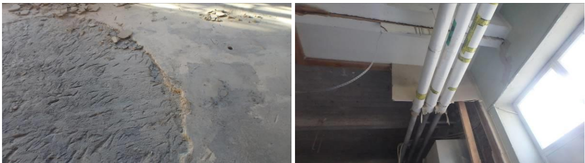
Lattioiden pintamassat (magnesiamassa) Putkien pahvieristeissä on käytetty asbestia sisältävät asbestia
