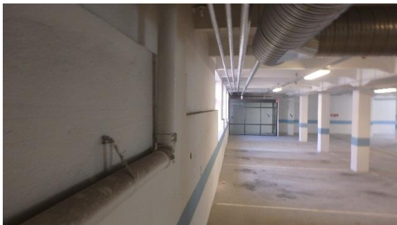
Rakennuksen 213 laajennusosan perusmuuri on erotettu sisäverhouksesta bitumi-takana oleva bitumihuopa (ASB.28 ja huopalla, kuva ensimmäisestä kerroksesta ASB.29) sisältää asbestia
