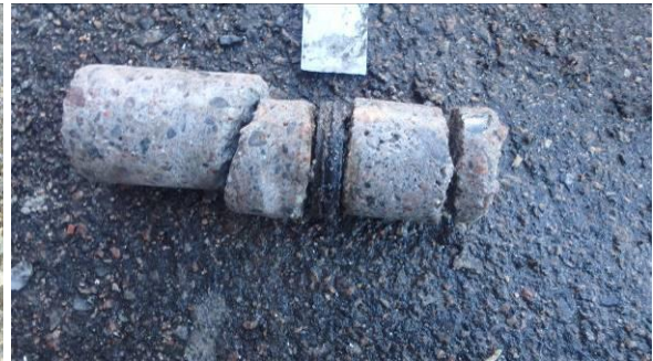
Pihakannen vanhassa vedeneristeessä (uudempi osa) on asbestia
