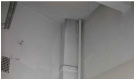
Tiloissa on havaittu muutamia asbestimenttiikanavia (kuva Optiplan 2016)
