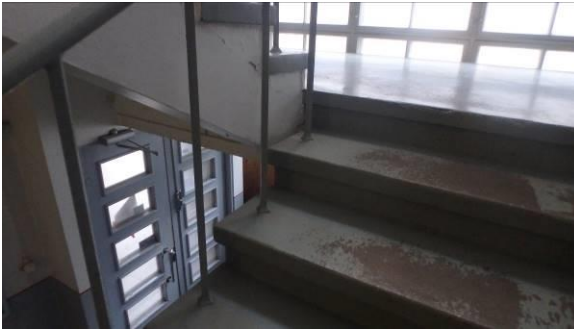
Portaan alapinnan maaleissa on käytetty raskasmetalleja
