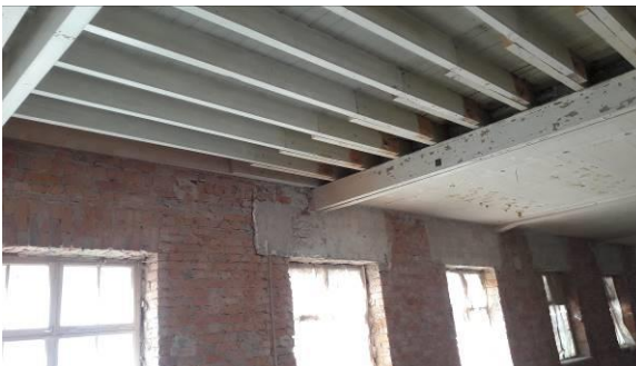
Yläpohjan laudoituksen maali sisältää vaarallista jätettä
