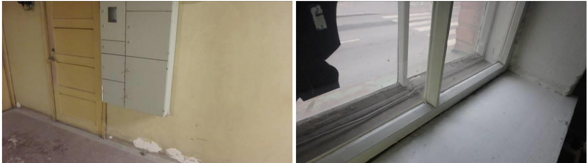
Käytävän (211) seinämaali ja tasoite sisäl- lkkunamaali (211) sisältää lyijyä tävät raskasmetalleja
