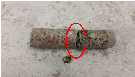
Laattojen välisessä kermässä (ja liimassa) PAH-yhdisteitä
